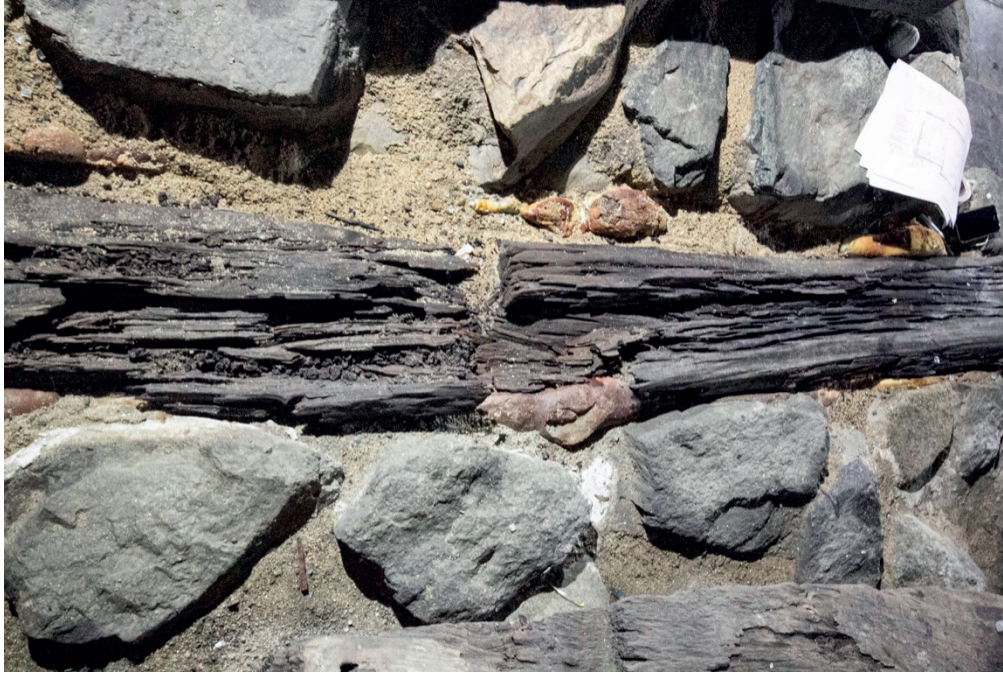
Figura 17: Detalle del deterioro asociado a las condiciones ambientales de la madera, en donde se puede apreciar resquebrajada la fibra en sentido longitudinal.
