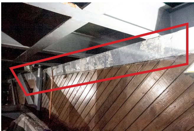
Fig. 52. Signos de eflorescencia producto de la humedad.
