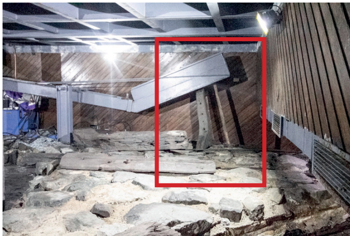
Fig. 51. Las estructuras del muelle se encuentran soportando el mecanismo hidráulico, sometidas de esta manera a una carga inadecuada para su conservación.
