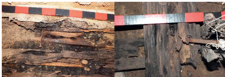
Fig. 80. Desintegración de la madera por alta humedad y acción de agentes biológicos.
