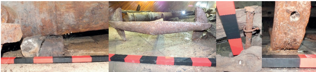
Fig. 61, 62, 63 y 64. Presencia de óxido en piezas metálicas.
