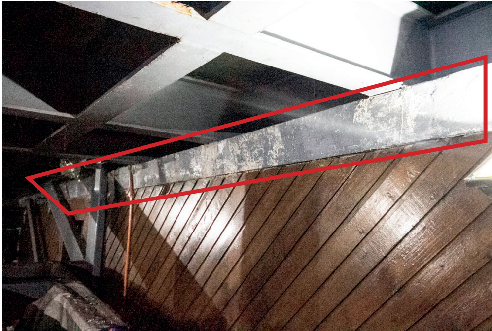
Figura 16: Signos de eflorescencia producto de la humedad.
