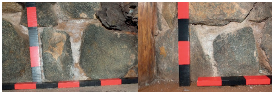
Fig. 56 y 57. Acumulación de cloruros en las piedras canteadas.
