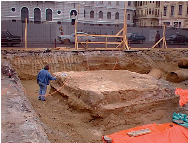
Fig.24. Vista general de los restos del cimiento en piedra canteada y argamasa del Monumento a Lord Cochrane.
