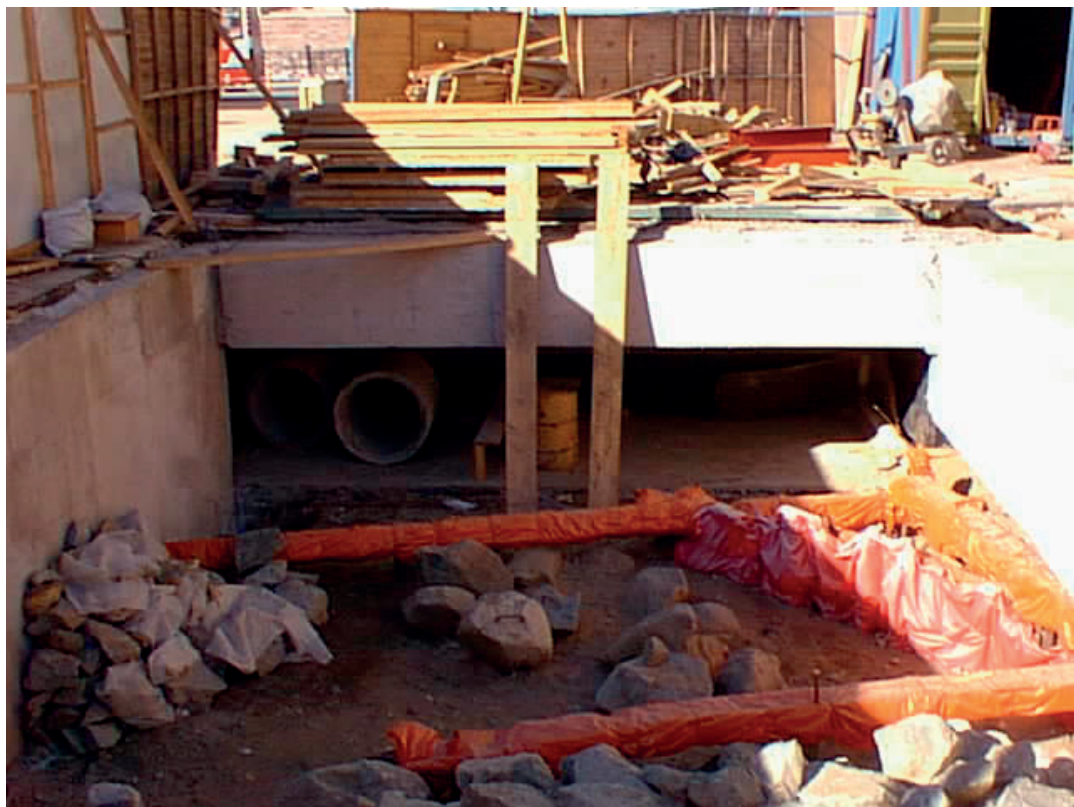
Fig. 49. Estado de avance de los trabajos de construcción del Museo de Sitio de Plaza Sotomayor al iniciarse la intervención arqueológica.
