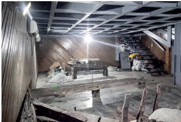
Fig. 50. Vista hacia sector sur, punto a partir del que se puede ver en el fondo acumulación de basura directamente apilada en el suelo, en bolsas.
