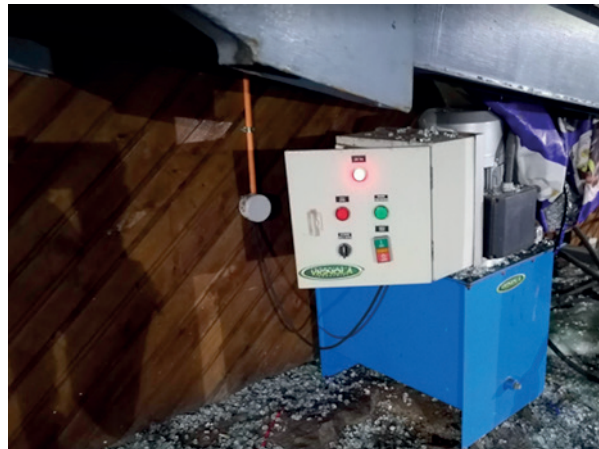
Fig. 54. Vista del mecanismo que permite el funcionamiento de la compuerta hidráulica.
