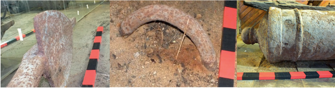
Fig. 58, 59 y 60. Acumulación de cloruros en piezas metálicas.
