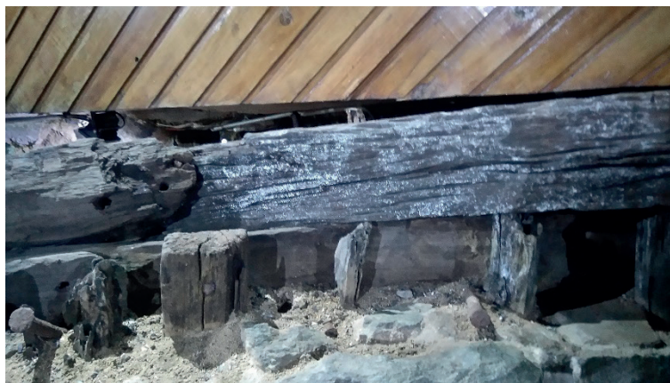
Fig. 68. Vista del Museo de Sitio en 2017. Presencia de hongos en los maderos in situ .
