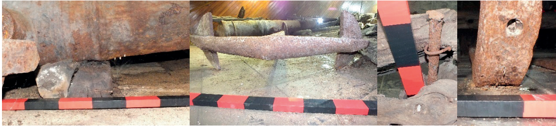
Fig. 76, 77, 78 y 79. Presencia de óxido en piezas metálicas.
