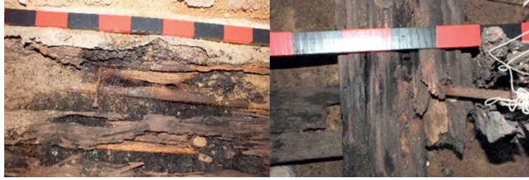
Fig. 65, 66. Desintegración de la madera por alta humedad y acción de agentes biológicos.
