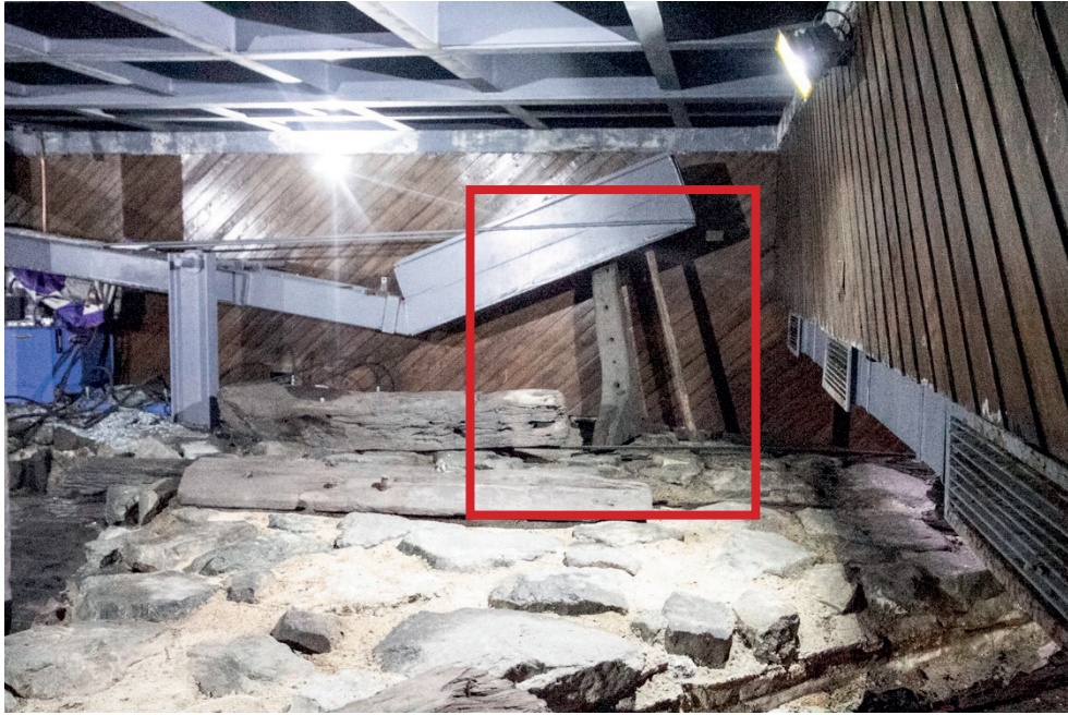
Figura 15: Las estructuras del muelle se encuentran soportando el mecanismo hidráulico, sometidas de esta manera a una carga inadecuada para su conservación.
