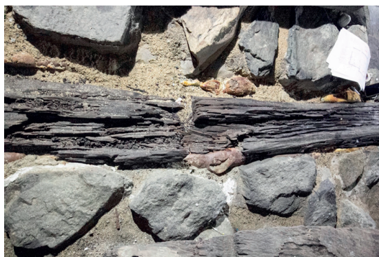
Fig. 53. Detalle del deterioro asociado a las condiciones ambientales de la madera, en donde se puede apreciar resquebrajada la fibra en sentido longitudinal.
