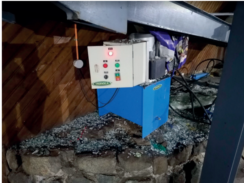
Figura 18: Vista del mecanismo que permite el funcionamiento de la compuerta hidráulica.
